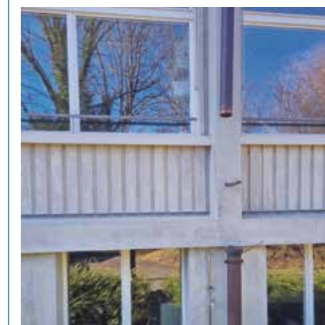
Da fehlt doch was: Kupferdiebe machten sich beim Schulhaus Wandermatte zu schaffen.
